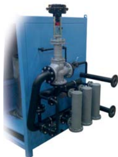
3 Wegeventil auf dem Kühlkreislauf
